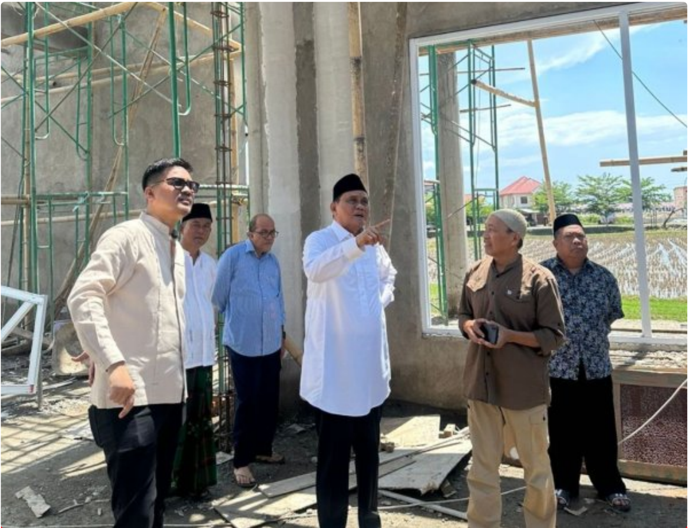
Bupati Barru, Ir. H. Suardi Saleh, M.Si, Ph. D (HC) melakukan pemantauan langsung terhadap perkembangan pembangunan Masjid Raya Kabupaten Barru
